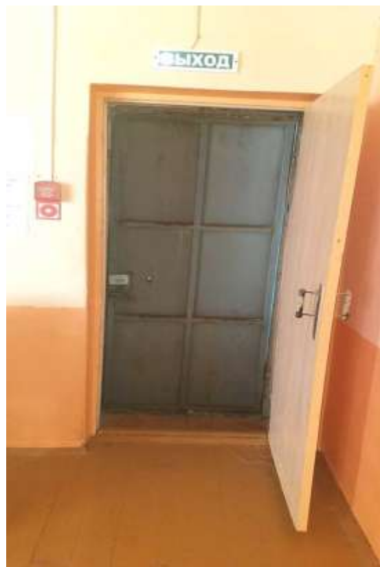
Путь эвакуации(входная дверь внутри здания) №13
