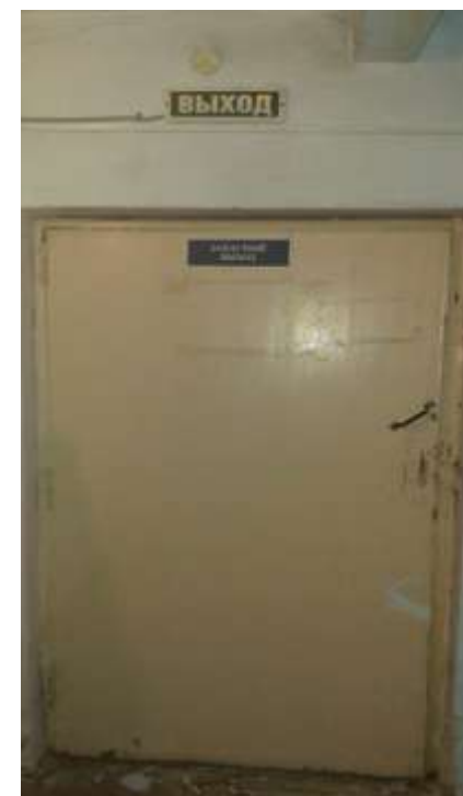
Путь эвакуации(входная дверь внутри здания) № 11
