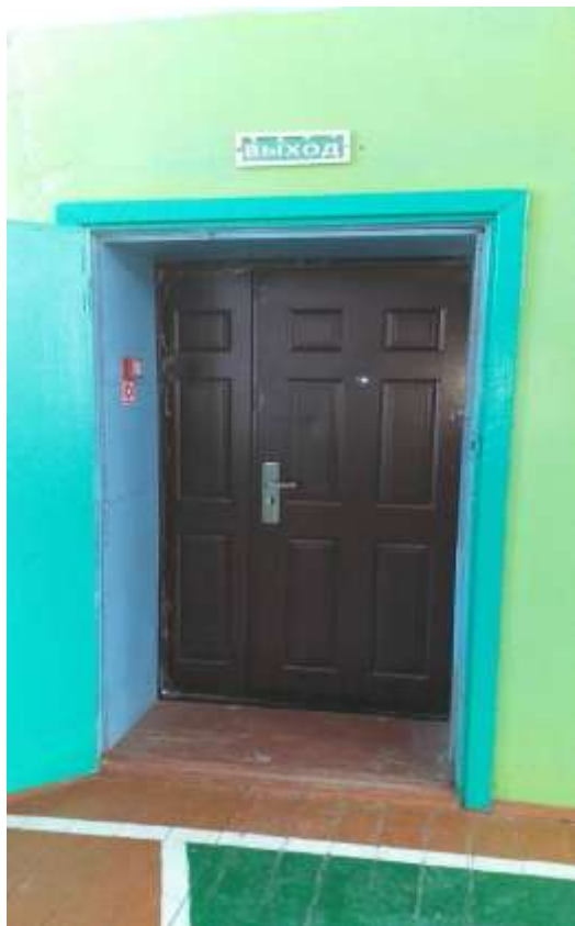
Путь эвакуации(входная дверь внутри здания) № 12
